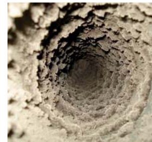
Schmutzige Lüftungsrohre bergen Risiken.
