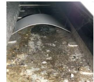
Lüftungsboden, überzogen von Schimmel, Schmutz und Staub.
