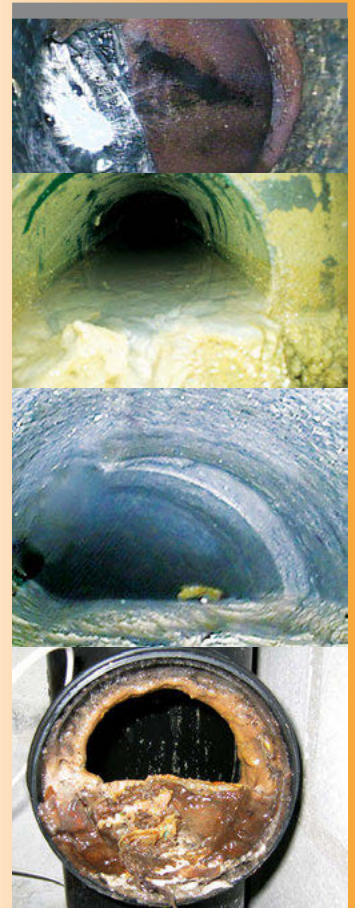
Tubulure d'une colonne de chute de cuisine
