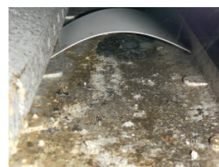
Lüftungsboden: überzogen von Schimmel, Schmutz und Staub.
