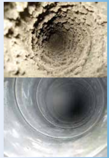
Einblick in ein Abluftrohr nach der Reinigung
