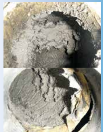
Stark verschmutzte und defekte Luftröhre bergen Risiken.
