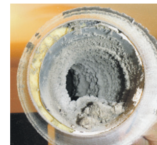
Obschon Abluftventile raumseitig sauber sind, sieht es kanalseitig anders aus.
