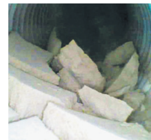
Baureste wurden einfach im Lüftungsrohr entsorgt.
