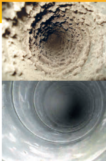
Einblick in ein Abluftrohr, vor und nach der Reinigung
