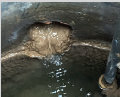
Verkalkte Sickerleitung mündet in einen Meteorschacht.
