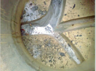
Drei Einläufe in einen Kontrollschacht. Nahe am Ablaufrohr (links) beginnt sich Schmutz anzusammeln.
