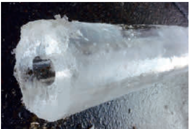
Entstanden über einer Laub/Schmutz-Verstopfung: eisige Sprengkraft aus einem Dachwasser-Fallstrang
