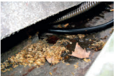
Herbstlaub ist der Entwässerung nicht gerade zuträglich.
